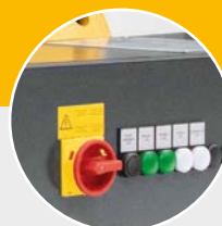
制御盤キャビネット での制御
